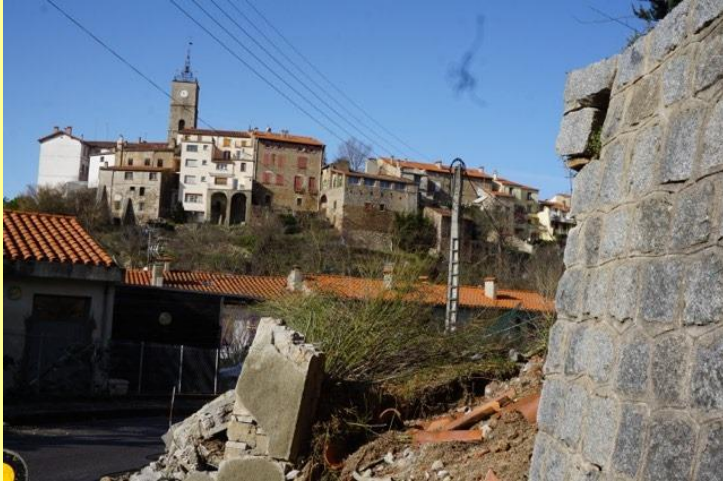
Ecroulement d'un mur de soutènement route du Bac
